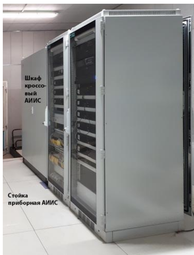
Рисунок 2 – Стойки и шкафы АИИС. Вид внешний
