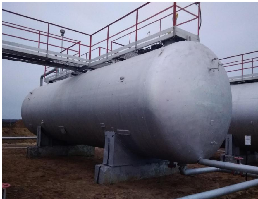
Рисунок 1 - Общий вид резервуаров РГС-76, РГС-77
