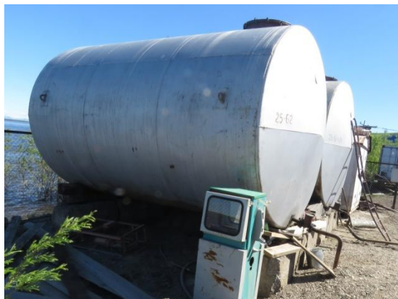
Рисунок 3 - Общий вид резервуаров стальных горизонтальных цилиндрических РГС-25
