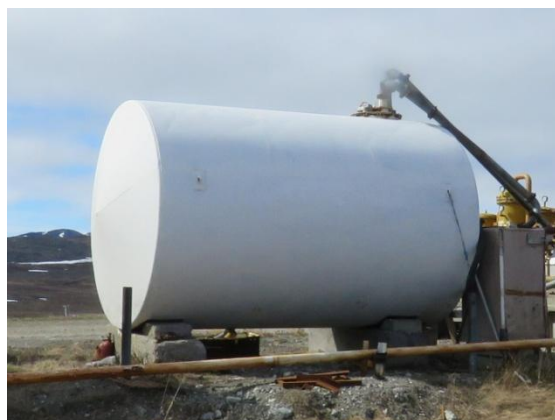
Рисунок 2 - Общий вид резервуаров стальных горизонтальных цилиндрических РГС-10
