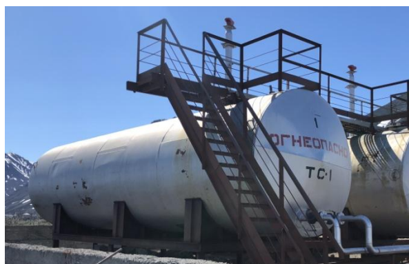
Рисунок 5 - Общий вид резервуаров стальных горизонтальных цилиндрических РГС-60
