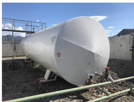
Рисунок 4 - Общий вид резервуаров стальных горизонтальных цилиндрических РГС-50
