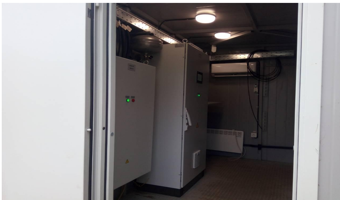
Рисунок 2 – Вид внутри контейнера
