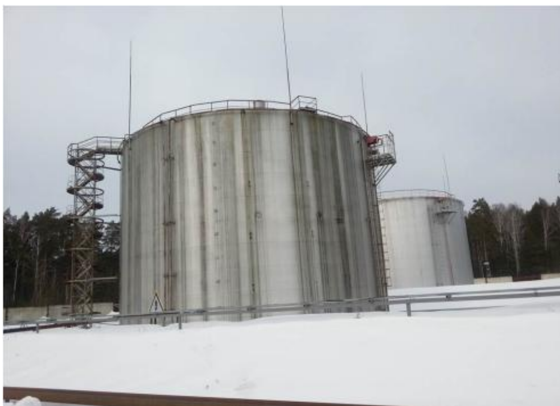
Рисунок 3 – Общий вид резервуара вертикального стального цилиндрического РВСП-5000
