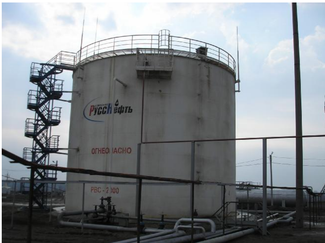
Рисунок 2 - Резервуар вертикальный стальной RBC-2000
