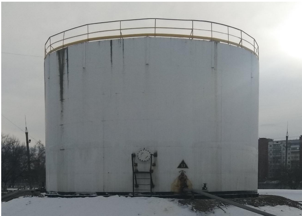
Рисунок 1 – Общий вид резервуара стального вертикального цилиндрического РВСП-1000
