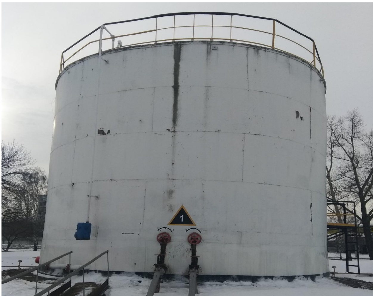
Рисунок 2 – Общий вид резервуара стального вертикального цилиндрического РВСП-400
