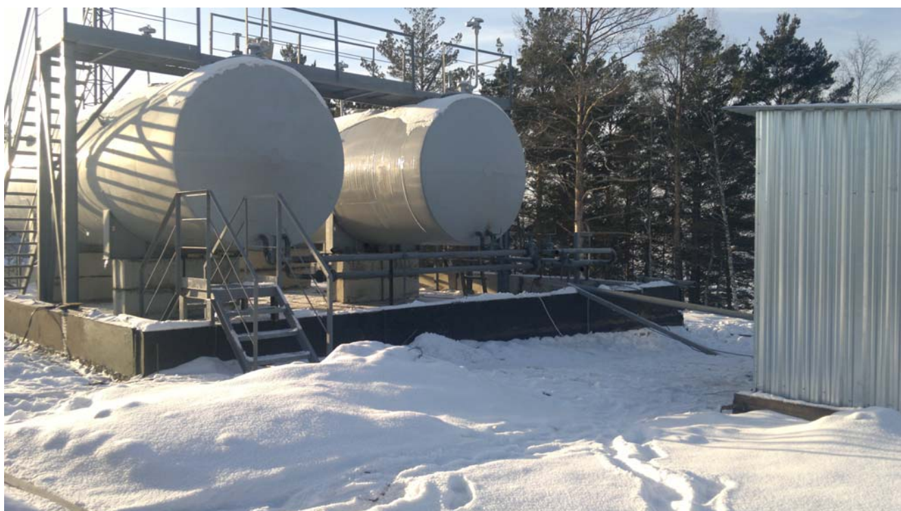
Рисунок 1 - Общий вид резервуаров горизонтальных стальных цилиндрических РГС-100
