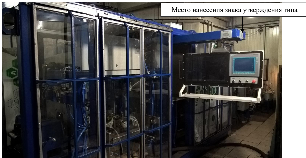
Рисунок 1 - Общий вид Установки
