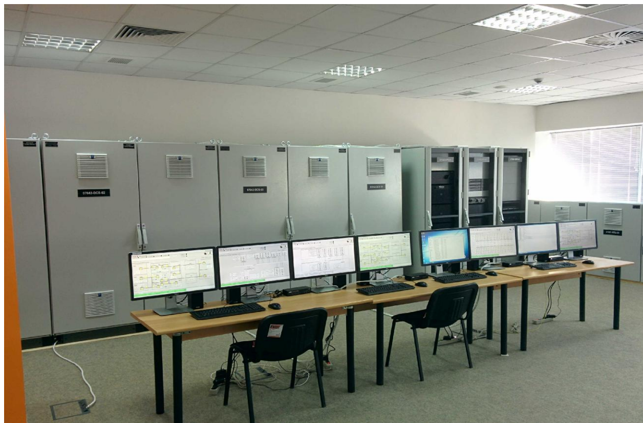
Рисунок 1 - Фотография общего вида АСУ ТП объекта «Обустройство нефтяного месторождения им. А.Титова. Вторая очередь»
