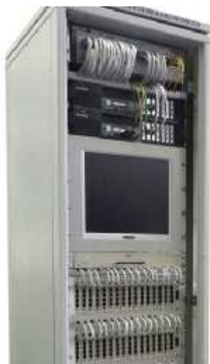
Рисунок 1 - Общий вид оборудования с открытой дверью
