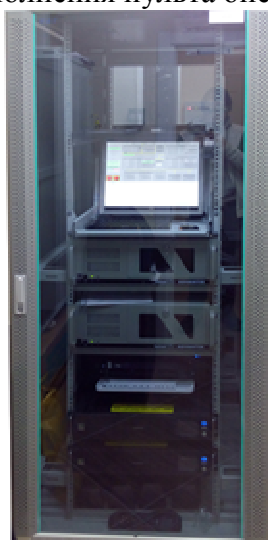
в) стойка серверного оборудования
