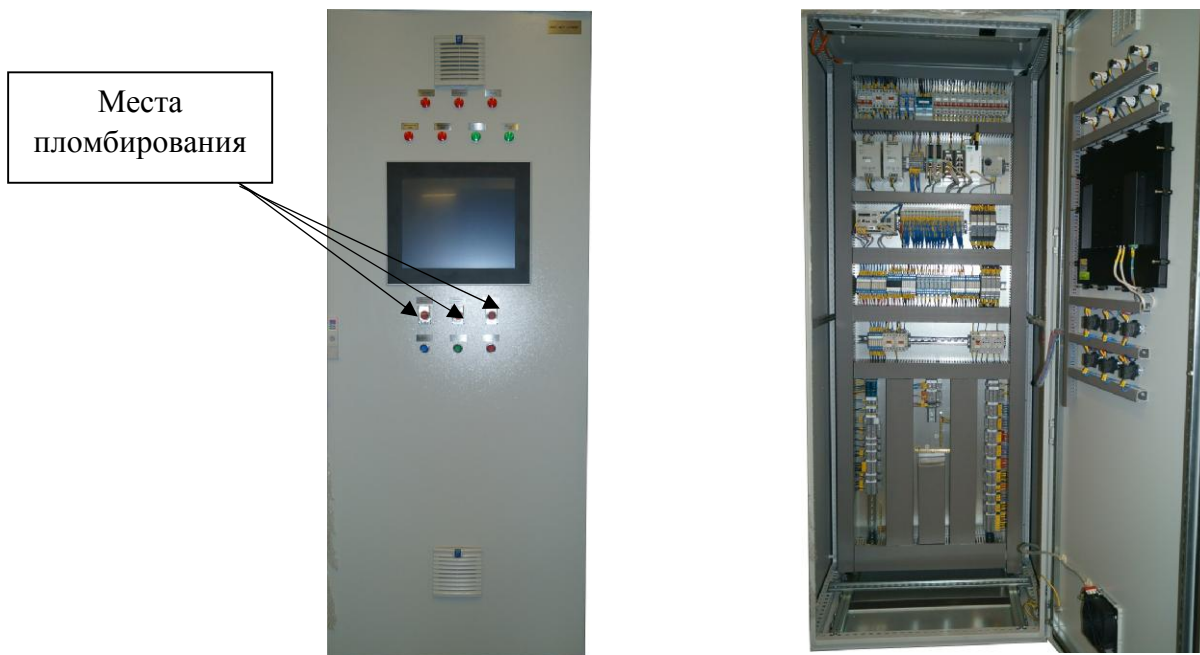
а) шкаф автоматики с информационно-измерительными каналами
