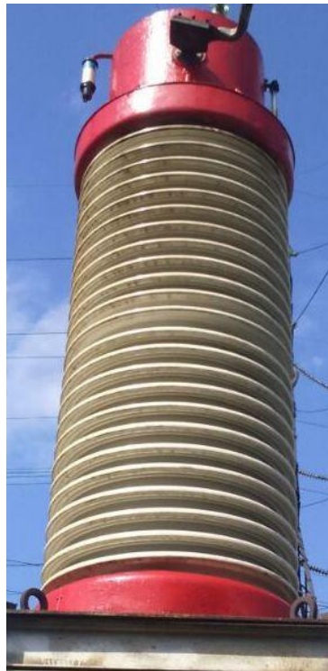
Рисунок 1 - Общий вид трансформаторов тока
