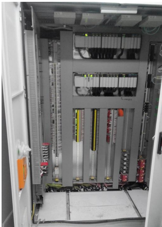
Рисунок 1 - Внешний вид электротехнического шкафа системы
