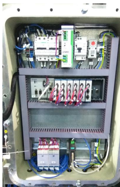
Рисунок 2 - Общий вид шкафа электротехнического со снятой дверцей
