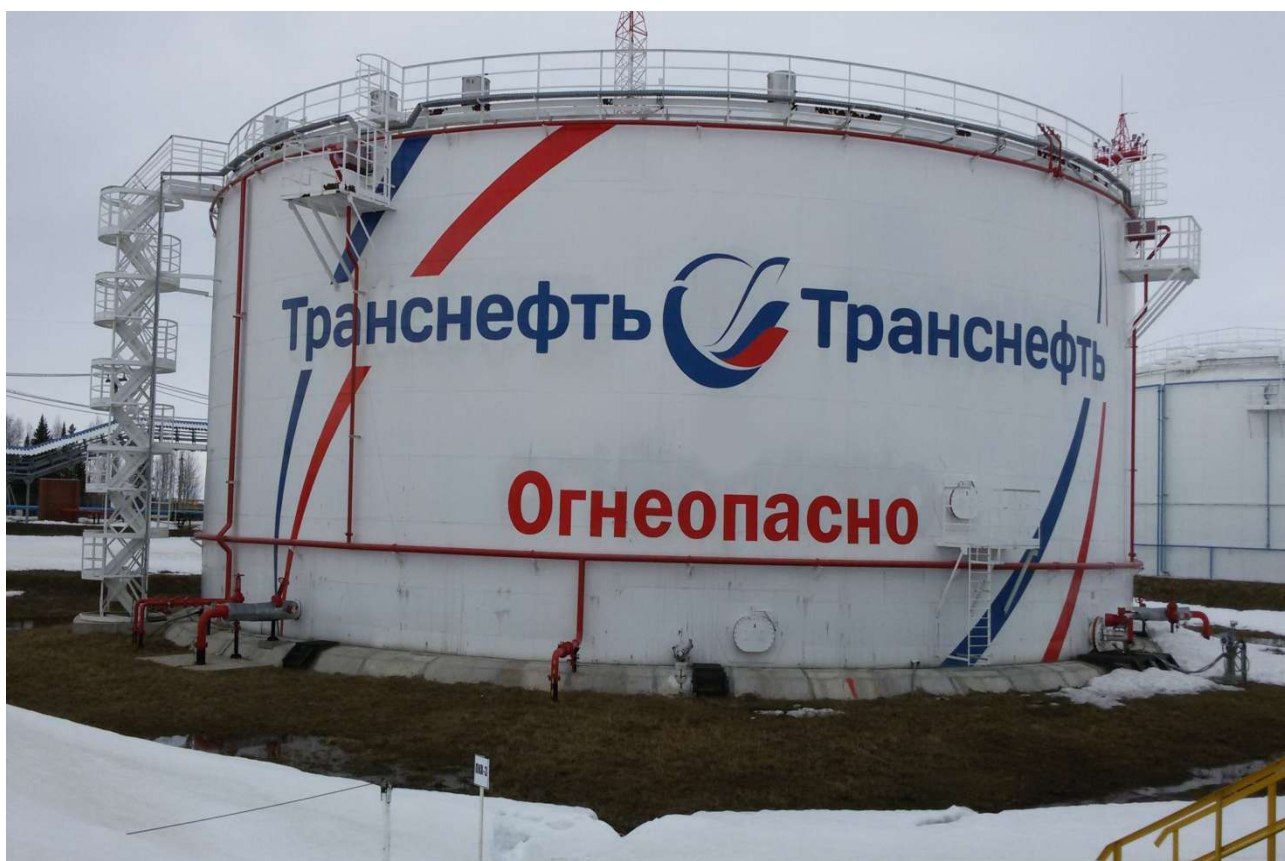
Рисунок 5 - Общий вид резервуара вертикального стального цилиндрического РВСП-10000
