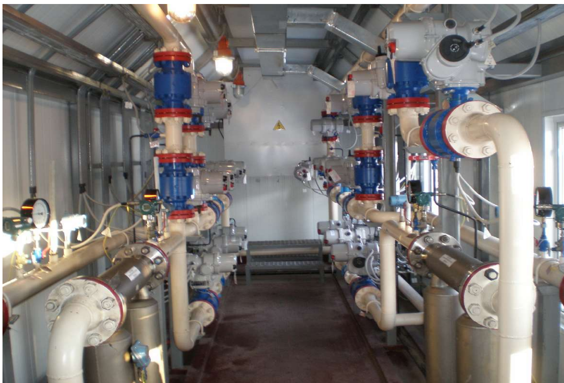
Рисунок 1 - Общий вид СИКН
