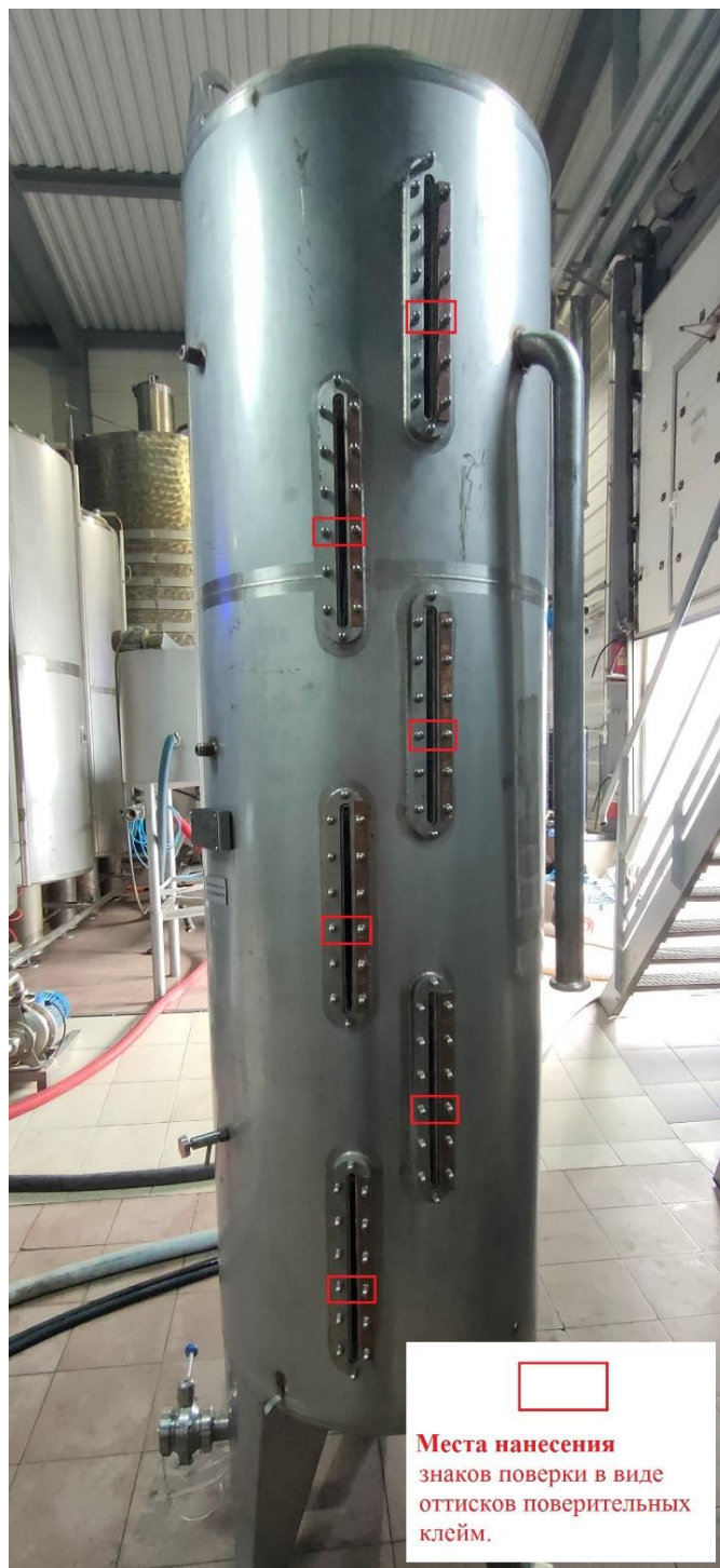
Рисунок 2 – Схема пломбировки мерника 1 класса V=0,75 \text{ м}^3 заводской № 5166.070 от несанкционированного доступа, обозначение места нанесения знака поверки
