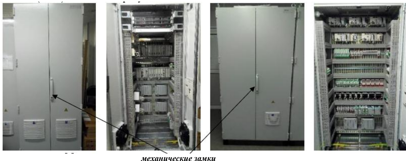
Рисунок 1 - Внешний вид шкафов комплекса
