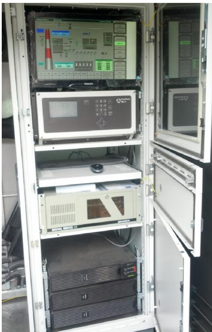
Рисунок 4 - Внешний вид шкафа с элементами системы
