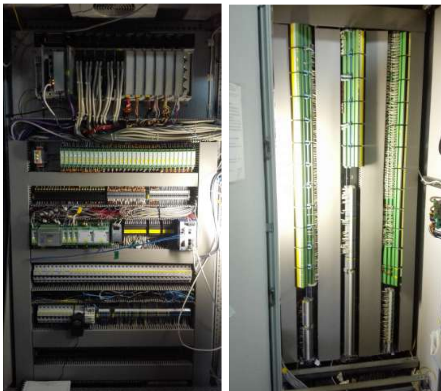
Рисунок 1 - Щит автоматического управления с контроллером PLC Modicon и модулями ввода
