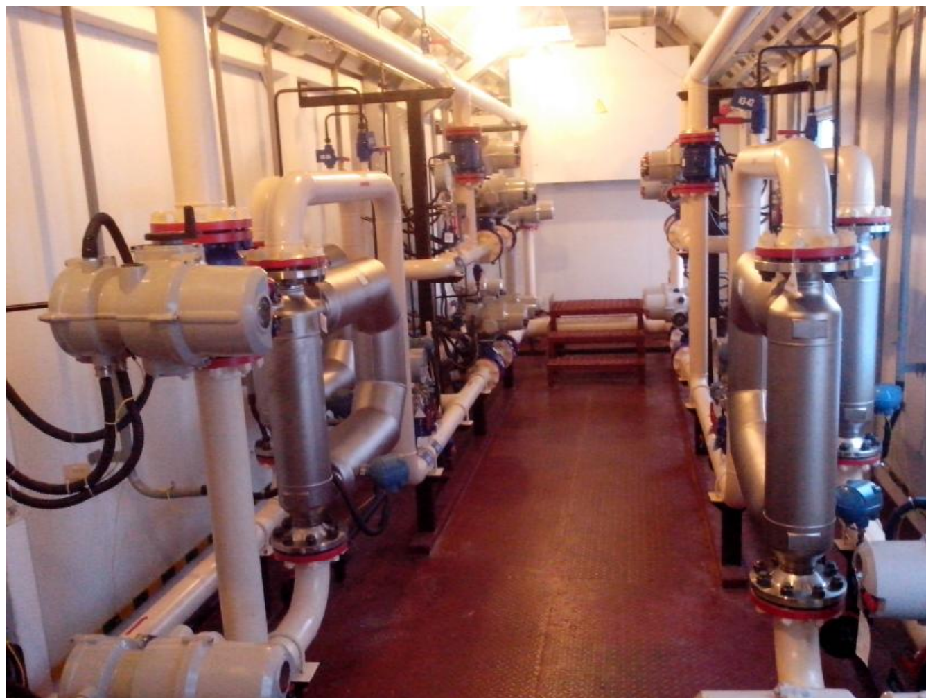
Рисунок 1 - Общий вид СИКН
