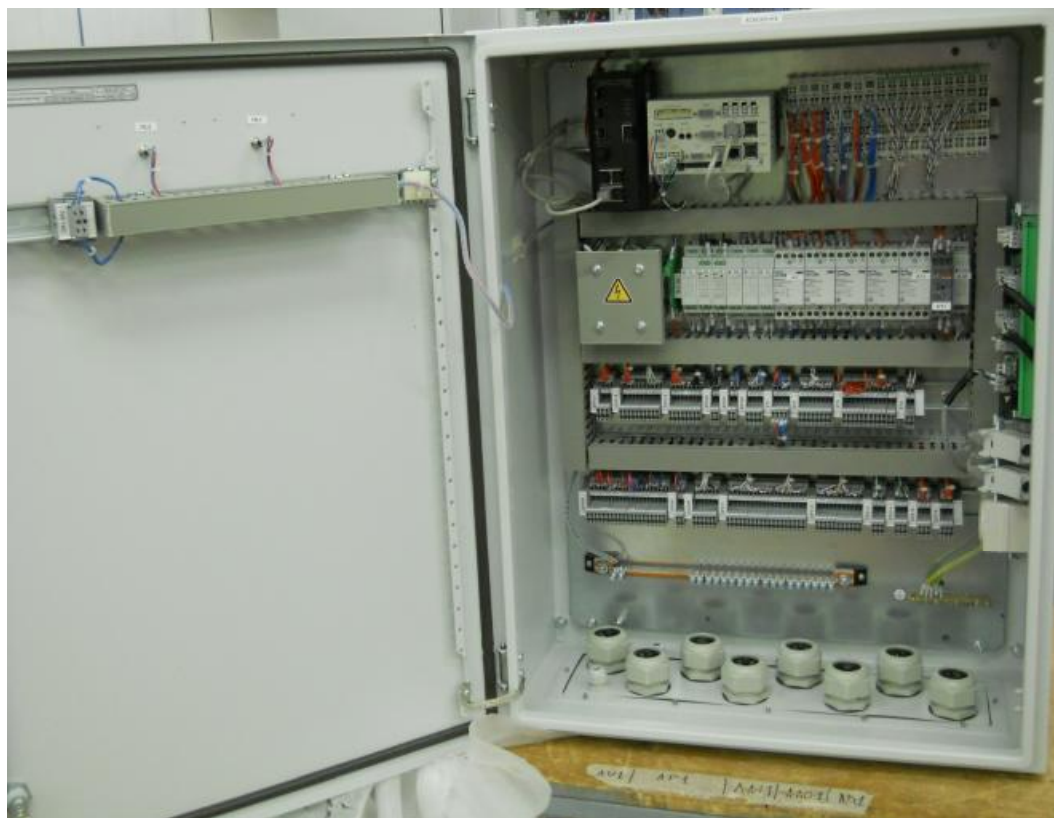
Рисунок 1 – Фотография общего вида щита автоматики комплекса
