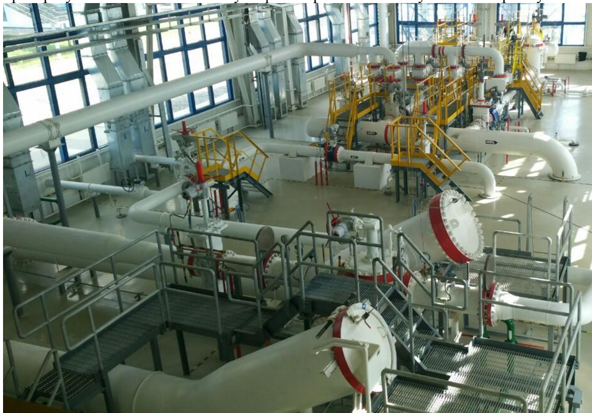
Рисунок 1 – Общий вид СИКН
