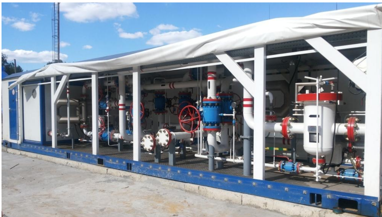
Рисунок 1 – Общий вид СИКН
