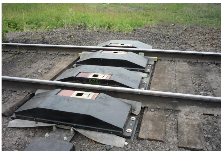
Рисунок 1 – Напольное оборудование Комплекса-2С
