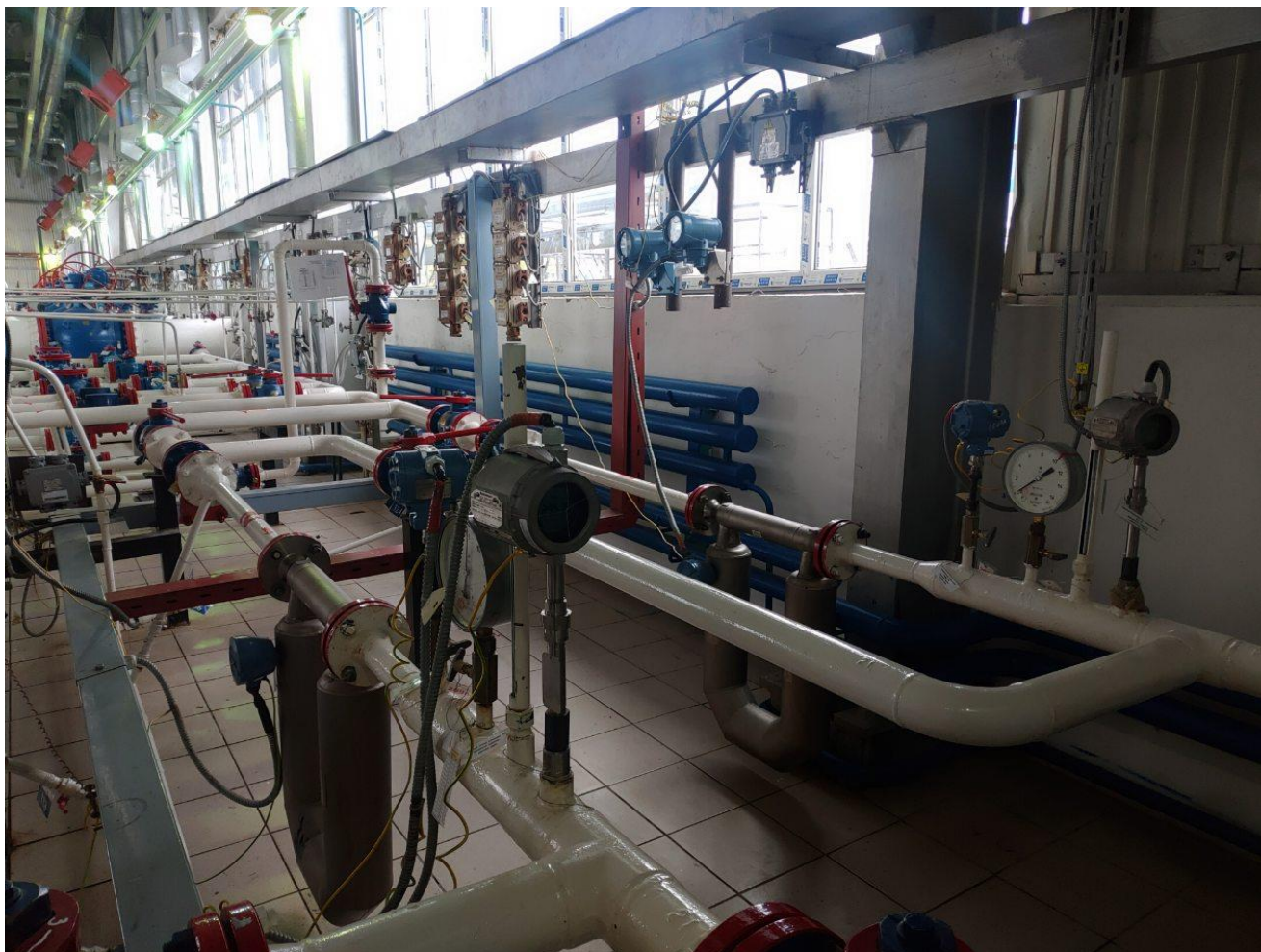
Рисунок 1 – Общий вид СИКН
