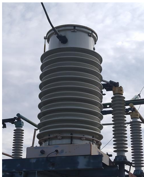
Рисунок 1 - Общий вид трансформаторов
