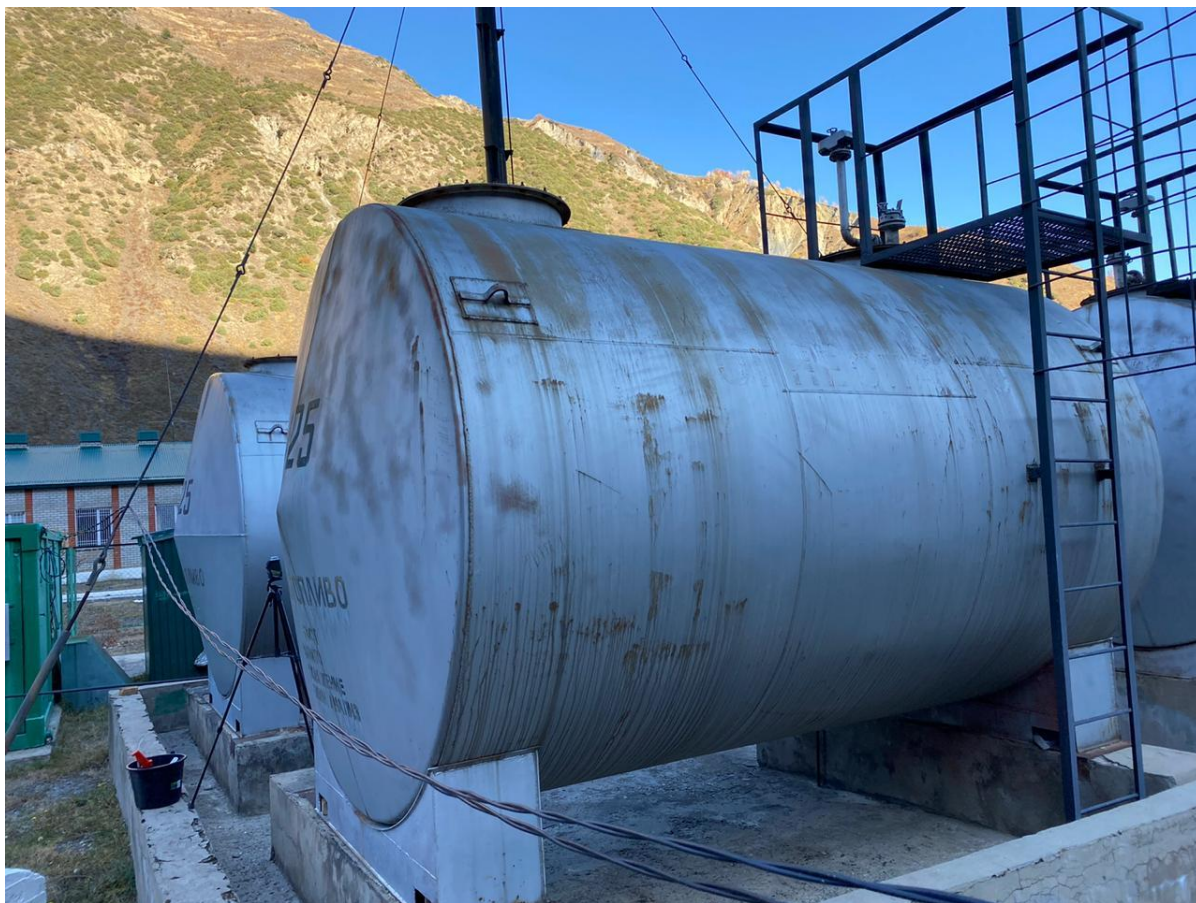
Рисунок 2 – Общий вид резервуаров РГС-25 зав.№№ 5, 191, 194, 195
