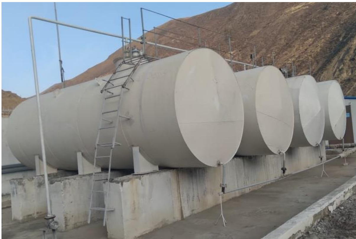
Рисунок 10 – Общий вид резервуаров РГС-25 зав.№№ 193, 194/1, 196, 197
