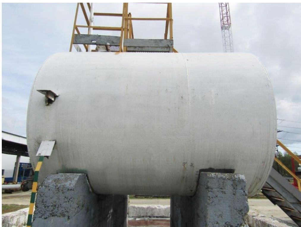
Рисунок 1 – Общий вид резервуаров РГС-10
