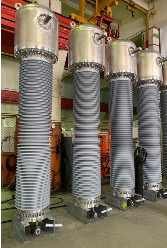
Рисунок 1 – Общий вид трансформаторов
