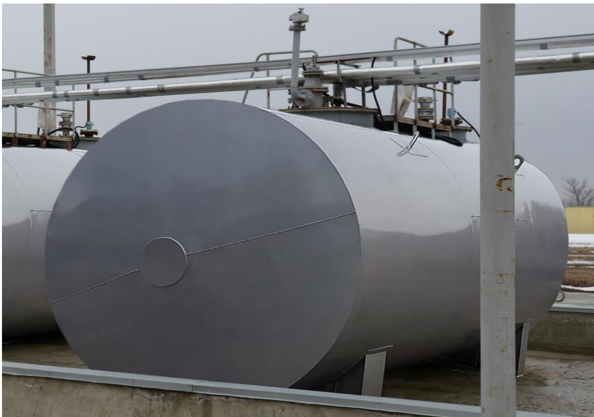
Рисунок 1 – Резервуар горизонтальный стальной РГС-25
