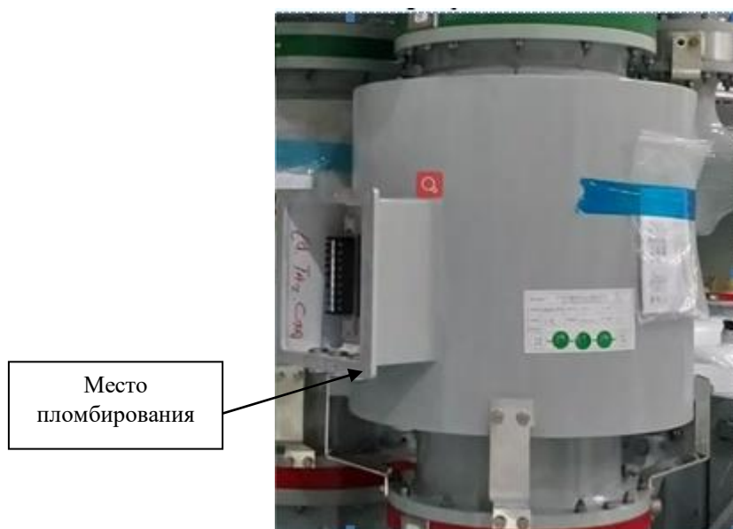
Рисунок 1 - Общий вид трансформаторов с указанием места пломбирования
