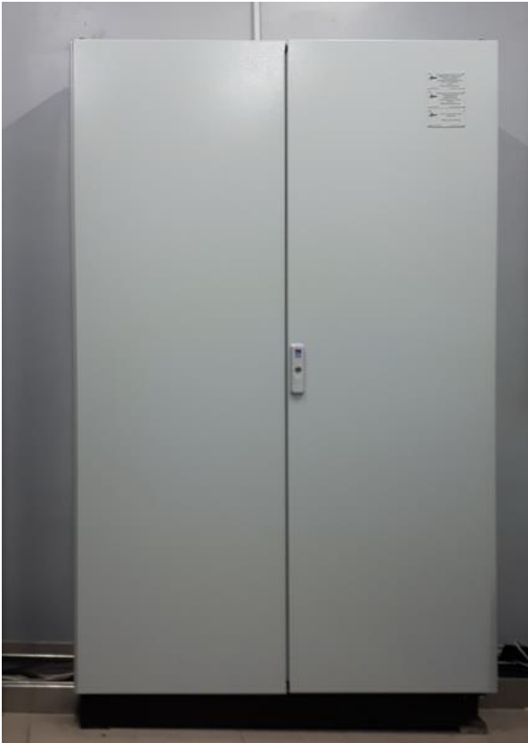
Рисунок 3 – Шкаф кроссовый АИИС. Вид внешний
