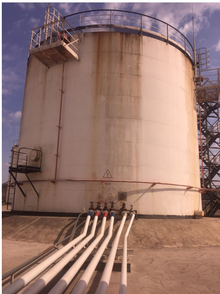
Рисунок 1 – Общий вид резервуаров стальных вертикальных цилиндрических РВСП-2000
