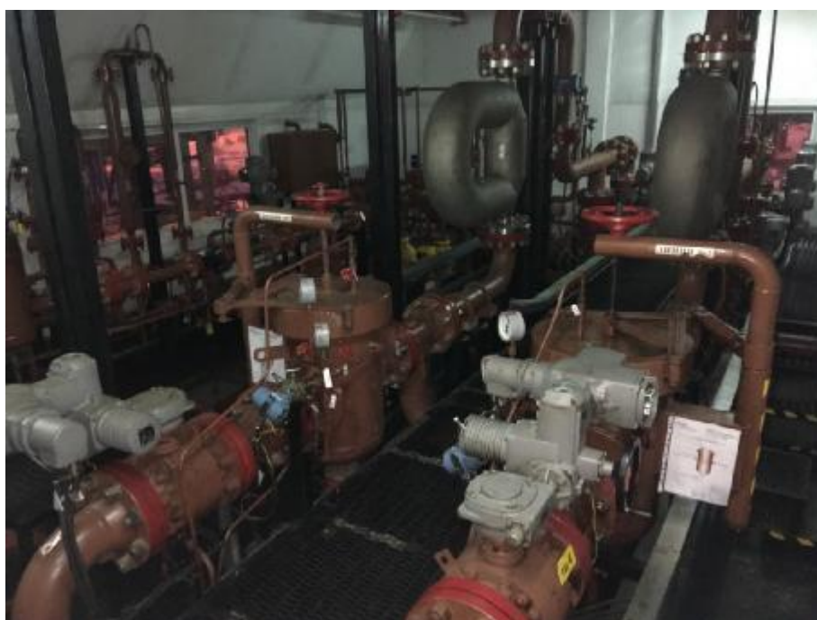
Рисунок 1 – Общий вид СИКН
