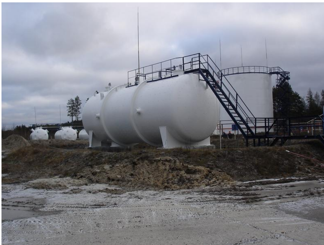
Рисунок 4 – Общий вид резервуара горизонтального стального цилиндрического РГС-200
