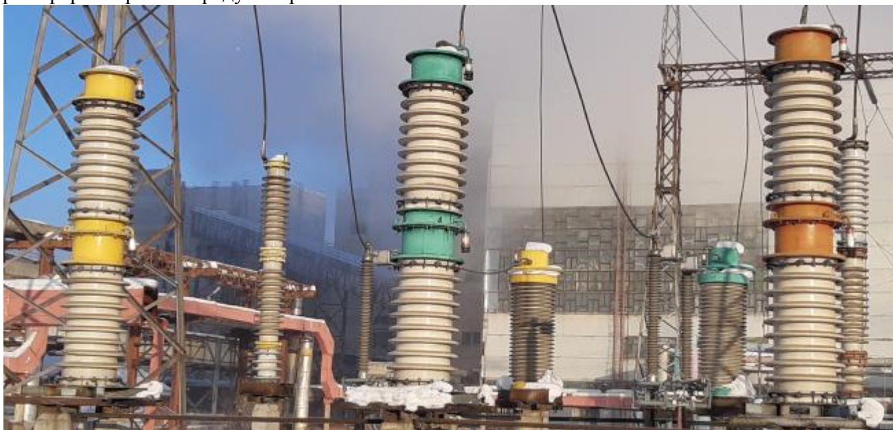
Рисунок 1 – Общий вид трансформаторов напряжения НКФ-220-58У1
