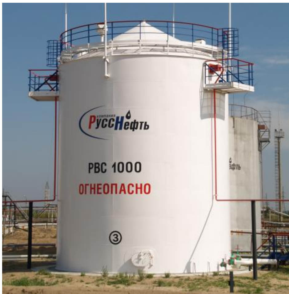
Рисунок 1 – Резервуар вертикальный стальной РВС-1000
