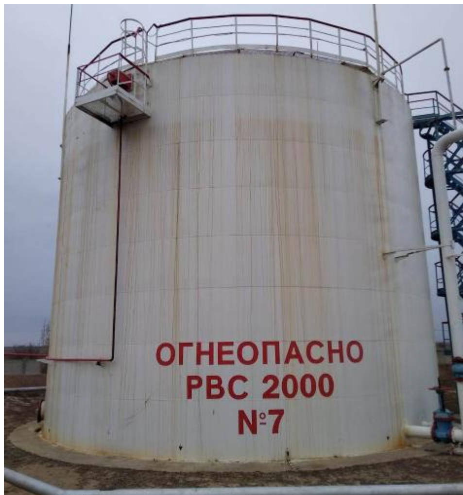
Рисунок 2 – Резервуар вертикальный стальной РВС-2000
