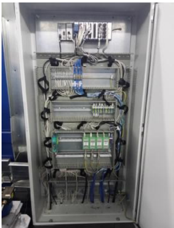
Рисунок 3 – Шкаф температурных параметров
