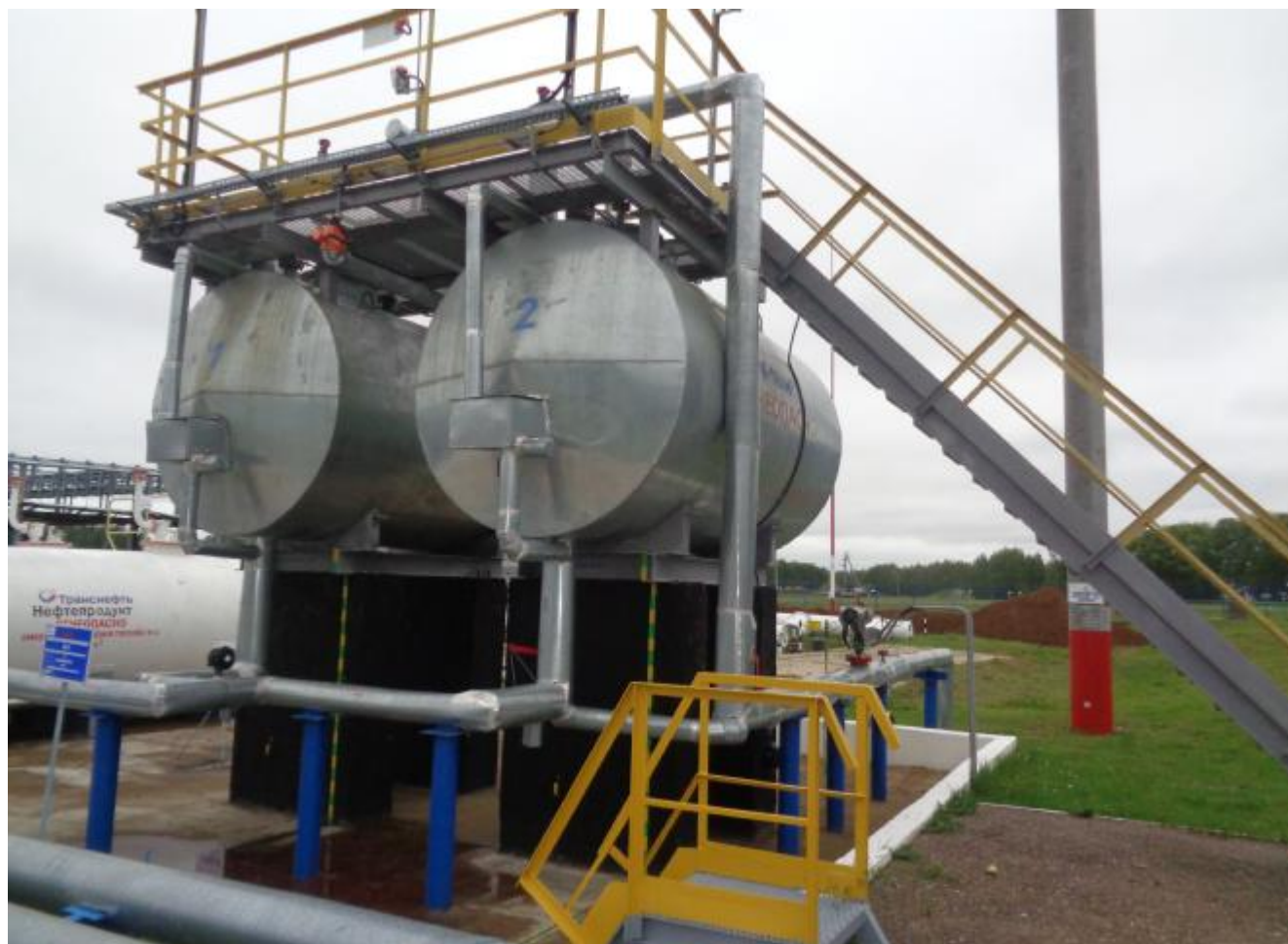
Рисунок 1 – Общий вид резервуаров стальных горизонтальных цилиндрических РГС-10
