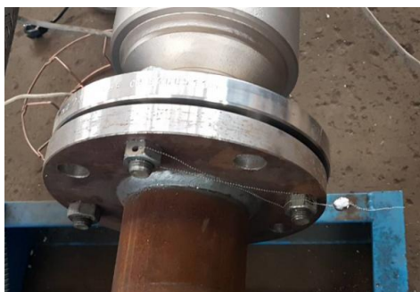
Рисунок 3 - Пломба поверителя, препятствующая демонтажу СРМ
