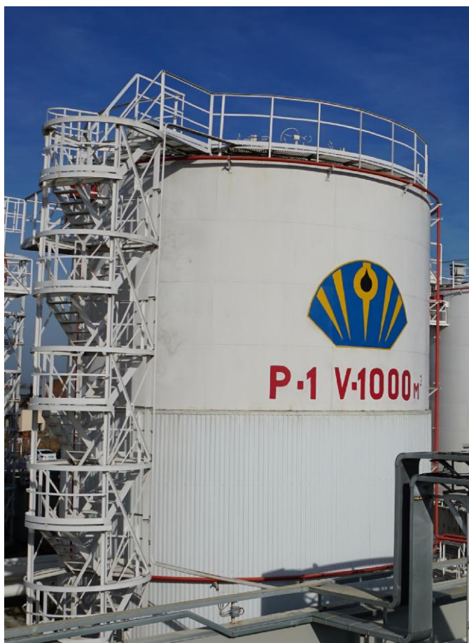
Рисунок 1 - Общий вид резервуара вертикального стального РВС-1000
