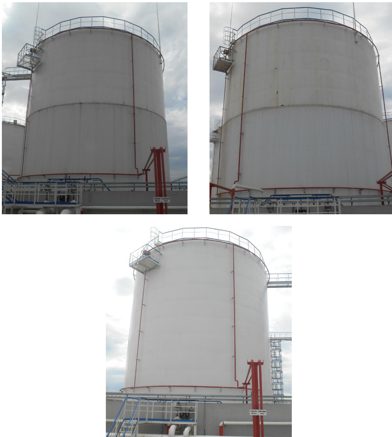
Рисунок 2 - Общий вид резервуаров вертикальных стальных РВС-3200
