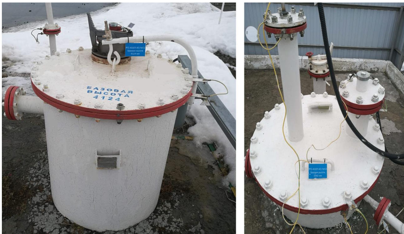
Рисунок 2 – Общий вид резервуаров РГС-40
