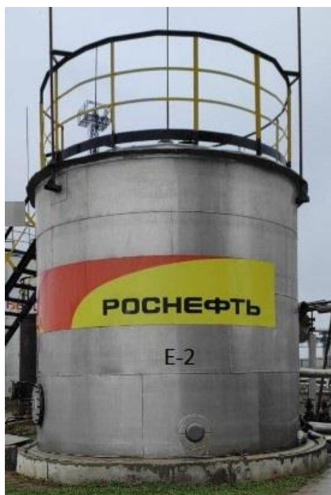
Рисунок 2 – Общий вид РВС-50 с заводским номером E-2
