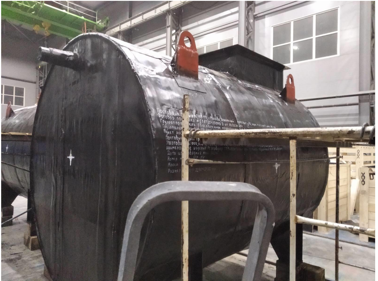
Рисунок 1 – Общий вид резервуаров РГСп
