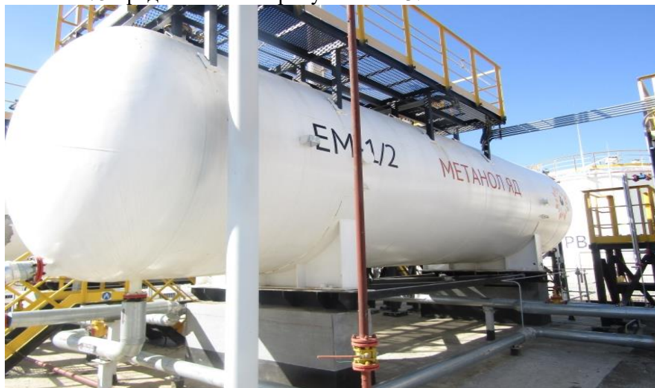
Рисунок 1 – Общий вид резервуаров горизонтальных стальных цилиндрических РГС-75
