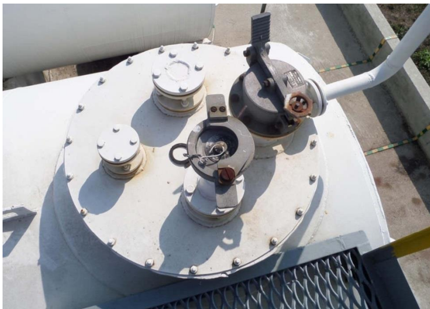
Рисунок 2 – Общий вид резервуаров РГС-10
