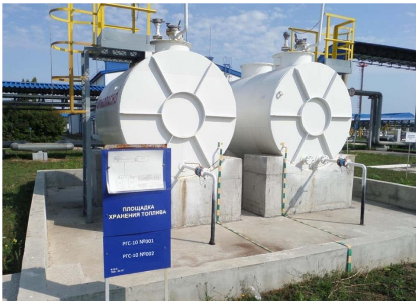
Рисунок 1 – Общий вид резервуаров РГС-10
