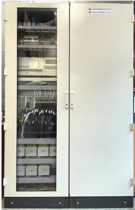
Рисунок 1 - Шкаф измерительного оборудования
