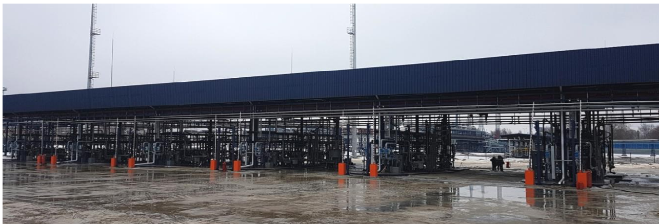
Рисунок 1 – Общий вид системы измерительной эстакады налива светлых нефтепродуктов в автотранспорт АО «Газпромнефть-МНПЗ»
